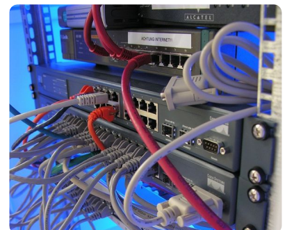
Switch im Rack
