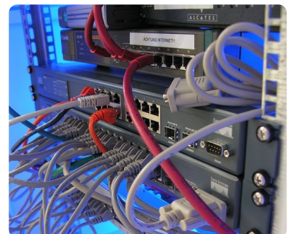
Switch im Rack
