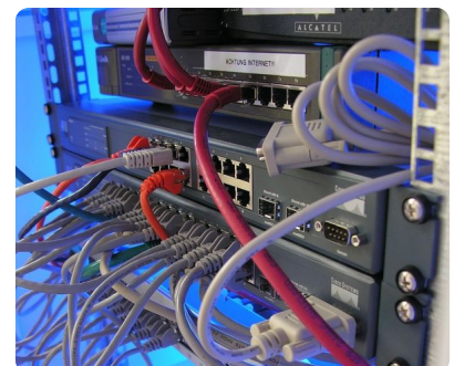
Switch im Rack
