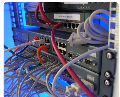
Switch im Rack
