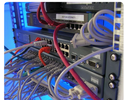
Switch im Rack
