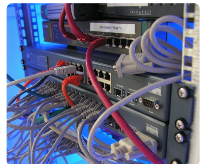
Switch im Rack
