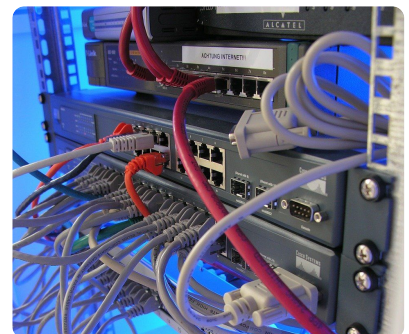
Switch im Rack
