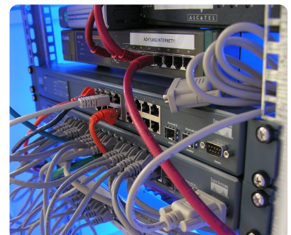
Switch im Rack
