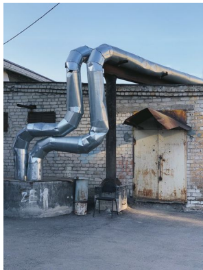
Rohrleitung mit Knick
