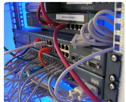
Switch im Rack
