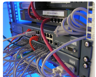
Switch im Rack
