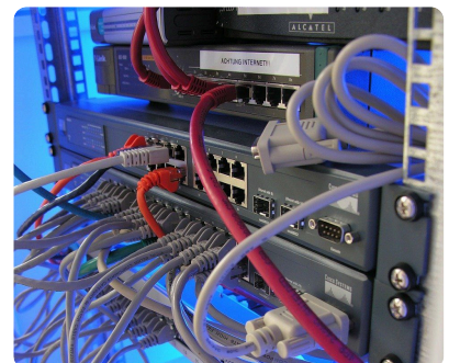
Switch im Rack
