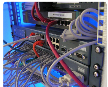
Switch im Rack
