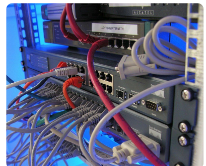
Switch im Rack
